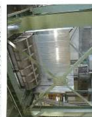
脱水設備 (脱水汚泥貯留ホッパ)
