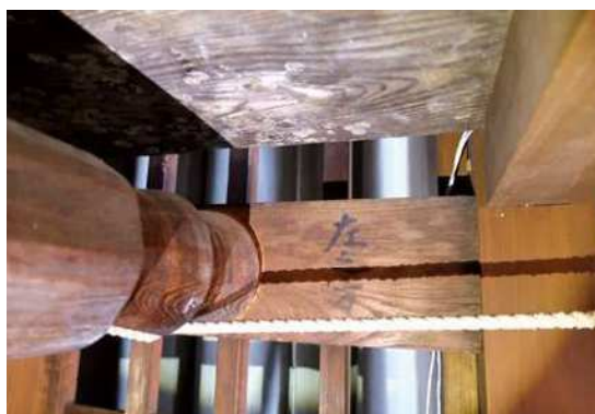
10 若戎車 下山内部側面 鯨梁・巻芯
