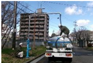
屋外給水用配管
