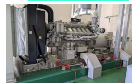
自家発電設備
