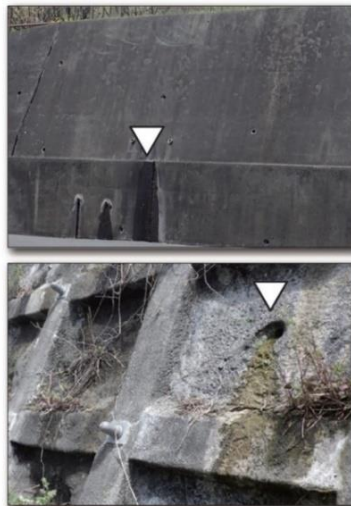
地下水の流出
