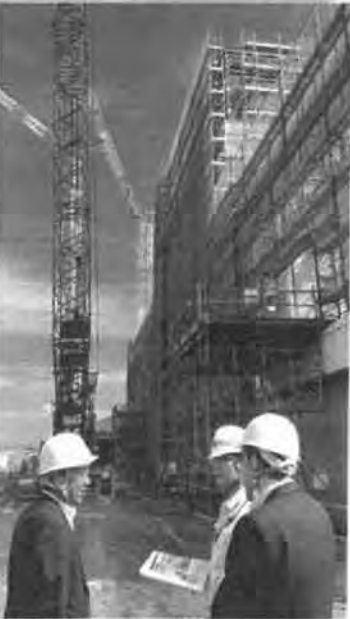
岐阜羽鳥衛生施設組合によるごみ処理施設建設工事現場を見学
