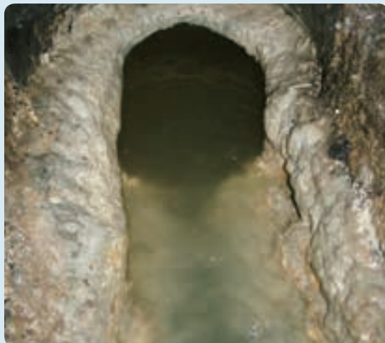
油脂類が付着した下水道管
