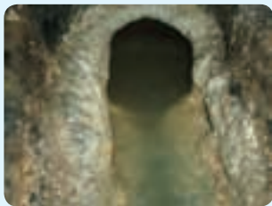
油脂類が付着した下水道管
