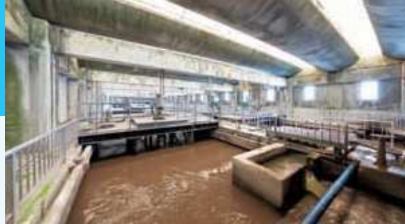
北部プラント 生物反応槽
