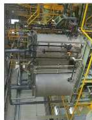
脱水設備 (混和槽・凝集槽)
