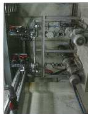
受入貯留設備（破砕ポンプ）
