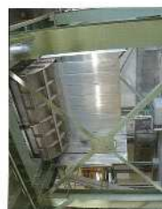
脱水設備（脱水汚泥貯留ホッパ）
