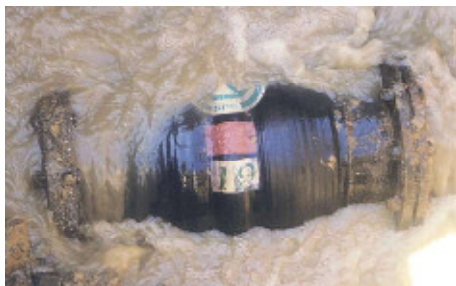
漏水した水道管
