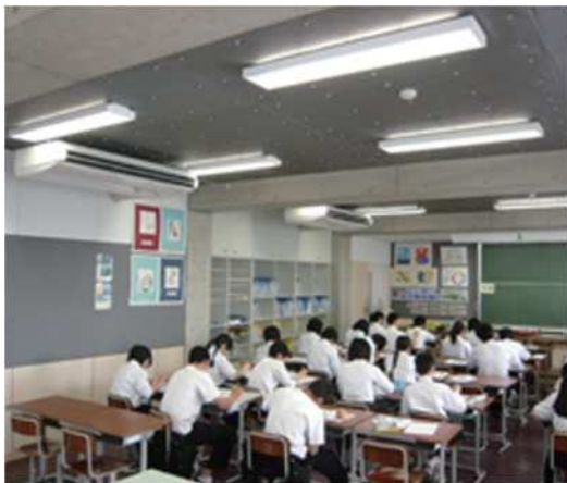
教室空調設備整備（エアコン）
