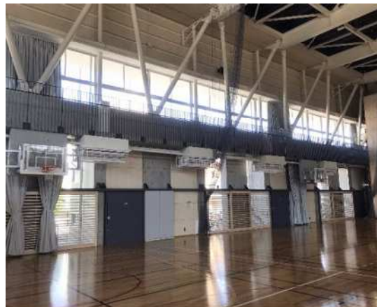
体育館空調設備整備（エアコン）
