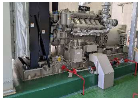
雄総水源地 自家発電設備
