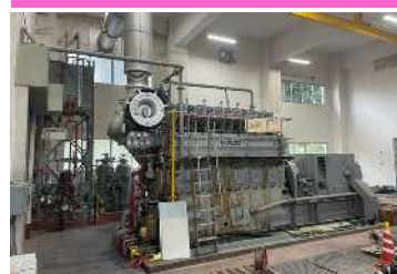
※鏡岩水源地の自家発電設備
