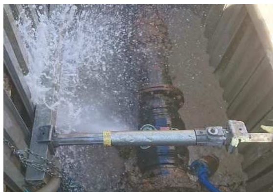
老朽化した水道管からの漏水状況
