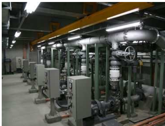
岩野田加圧施設
