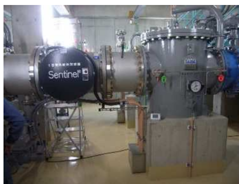
雄総水源地 紫外線処理装置
