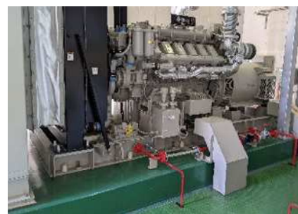
雄総水源地 自家発電設備
