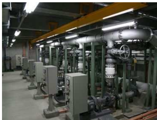
岩野田加圧施設
