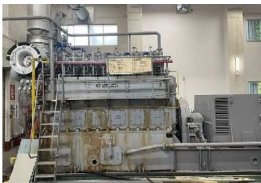
老朽化した鏡岩水源の自家発電設備
