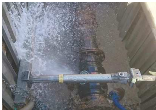
老朽化した水道管からの漏水状況
