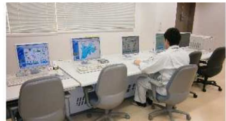
中央監視室での遠隔監視
