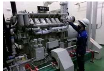
自家発電設備の点検訓練
