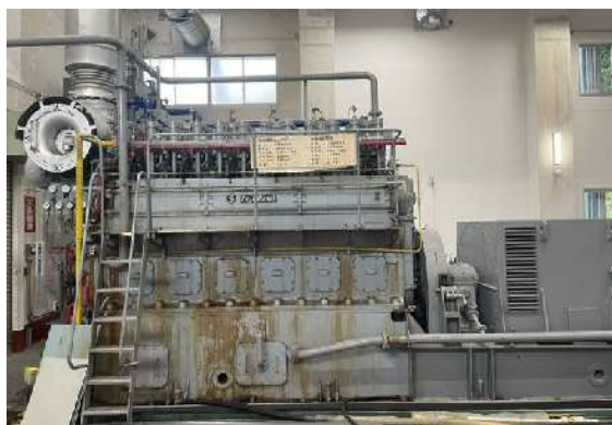
老朽化した鏡岩水源地の自家発電設備
