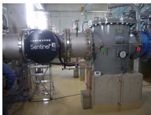
雄総水源地 紫外線処理装置
