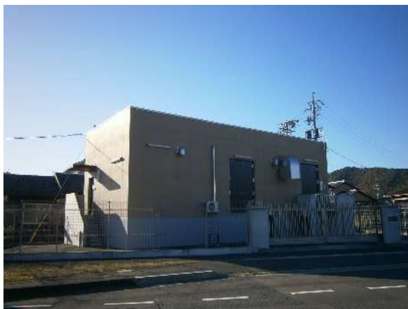
黒野第1 加圧施設
