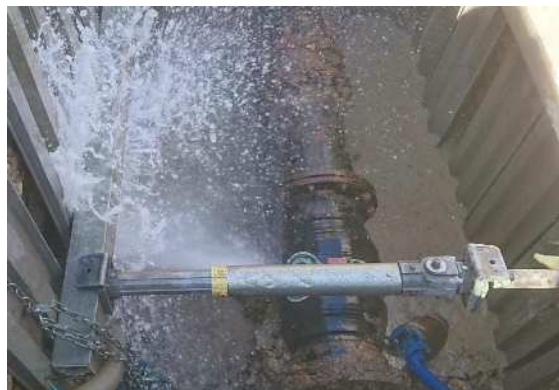
老朽化した水道管からの漏水状況
