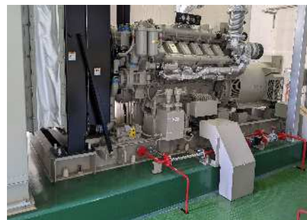
雄総水源地 自家発電設備
