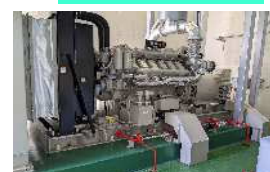
自家発電設備
