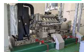
自家発電設備
