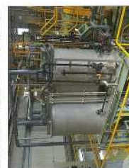
脱水設備 (混和槽・凝集槽)
