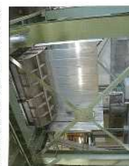
脱水設備 (脱水汚泥貯留ホッパ)
