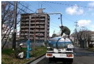
屋外給水用配管
