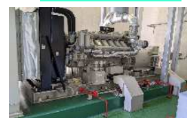
自家発電設備
