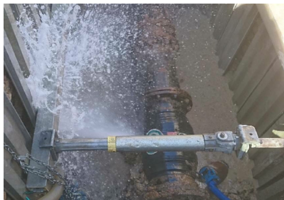
老朽化した水道管からの漏水状況
