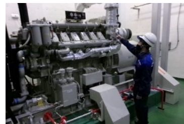
自家発電設備の点検訓練
