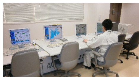
中央監視室での遠隔監視
