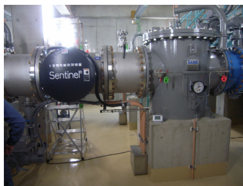
雄総水源地 紫外線処理装置
