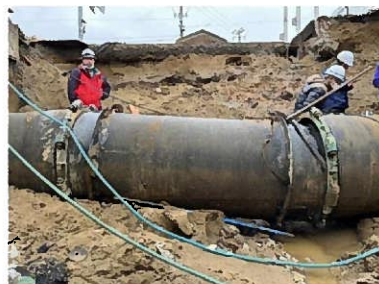
送水管の被害
