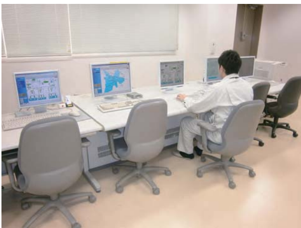
水道施設監視装置
