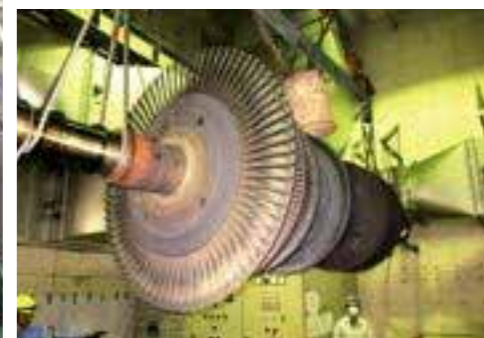
タービン ごみを燃やした熱で水から蒸気を作り、蒸気の力でタービンを回転させます。(写真は点検時)
