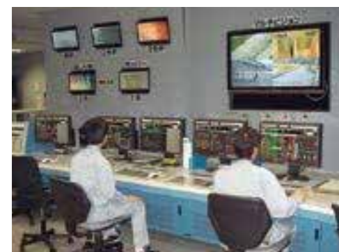
中央制御室 焼却場の機械をコンピューターを使ってコントロールをするところです。
