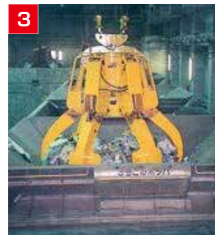
ごみホッパ ごみピットのごみをクレーンでつかんで焼却炉に入れるところです。
