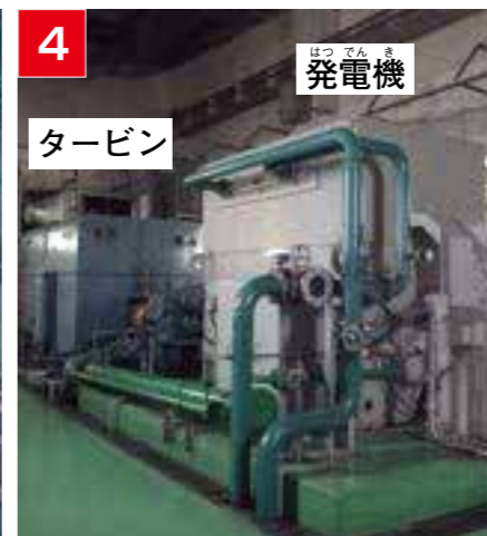
タービン発電機 タービンが回転することで、発電機も回転して電気が作られます。電気は施設内や市庁舎などで使い、残りは電力会社へ売ります。
