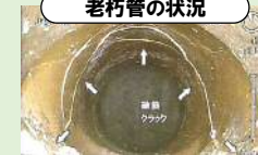
管の破損・クラック
