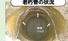
管の破損・クラック
