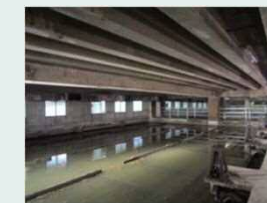
南部プラント 昭和48年供用開始 (築50年)
