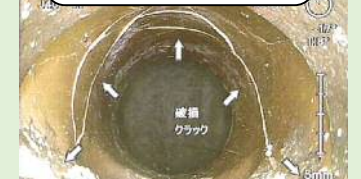
管の破損・クラック
