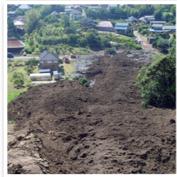
廃棄された土砂の崩落により 軽傷者1名、県道通行止め
