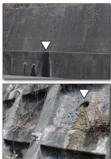
地下水の流出
