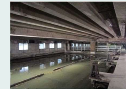
南部プラント 昭和48年供用開始 (築50年)
