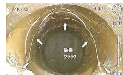
【老朽管の状況】
