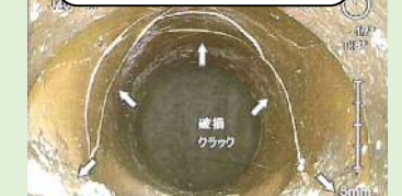
管の破損・クラック
