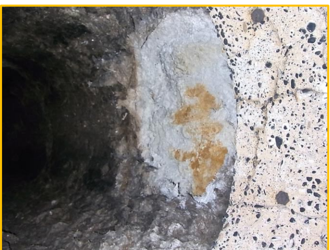
④煙突用石綿断熱材
