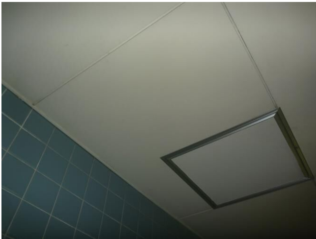
①石綿含有けい酸カルシウム板第1種
