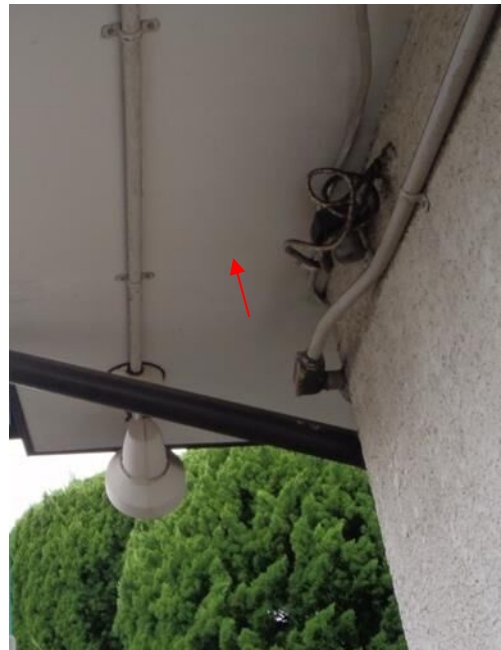
⑧石綿含有けい酸カルシウム板第1種
