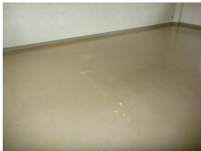
⑤石綿含有ビニル床シート
