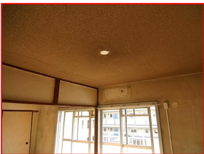
③石綿含有吹付けパーミキュライト (ひる石吹付け材)
