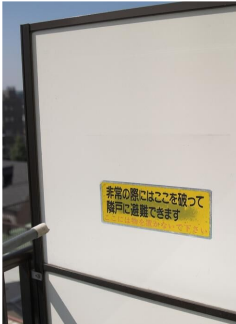
⑦石綿含有フレキシブル板
