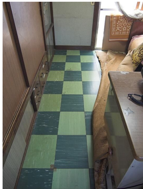
④石綿含有ビニル床タイル
