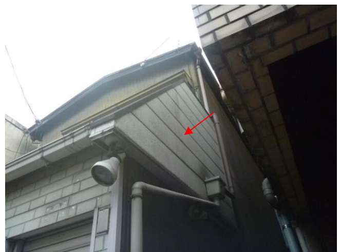
⑥石綿含有窯業系サイディング
