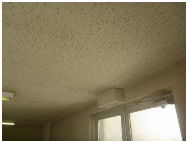
③石綿含有ロックウール吸音天井板
