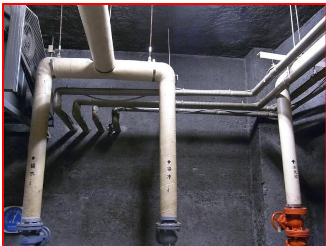
①吹付け石綿(クロシドライト)
