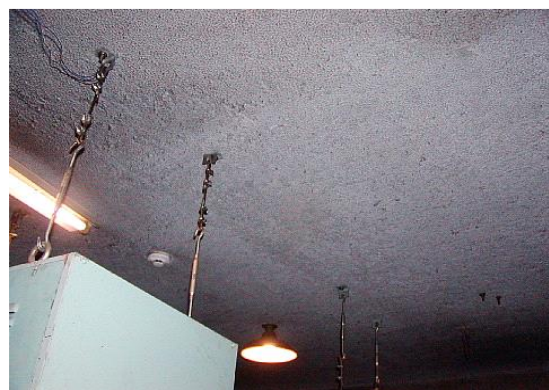
天井、一部に吊りボルト増設の痕あり、一部で剥落箇所あり
