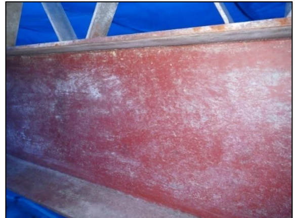
図 4.7.70 再付着した石綿の例
