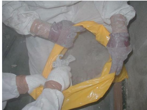
図 4.7.76 袋詰めした石綿廃棄物への粉じん飛散防止処理剤を散布
