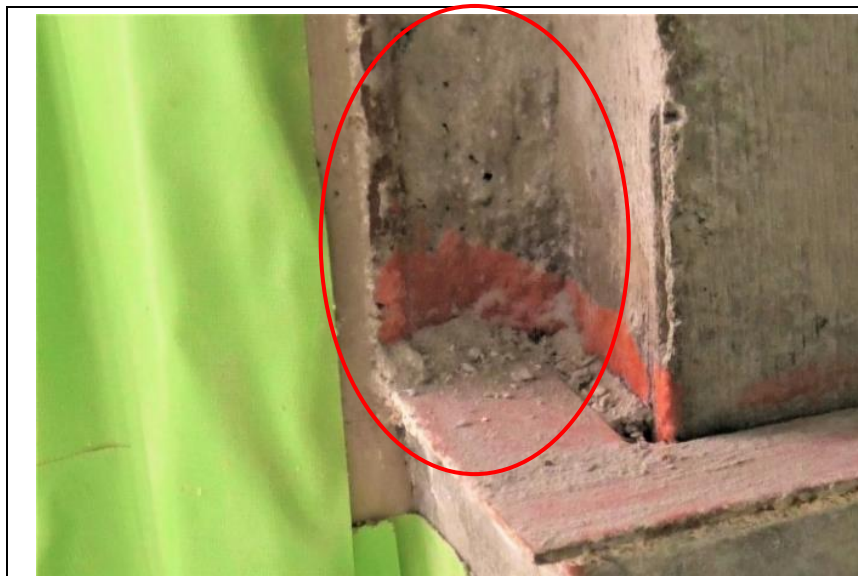
腰壁入隅部の清掃不良
