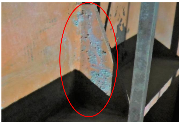
鉄骨梁側面の取り残し
