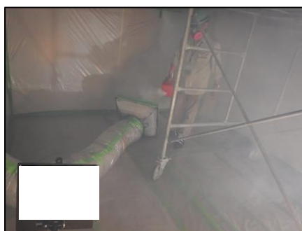
図4.14.8 スモークマシンを使用した 空気の流れの確認 (集じん・排気装置設置時)
