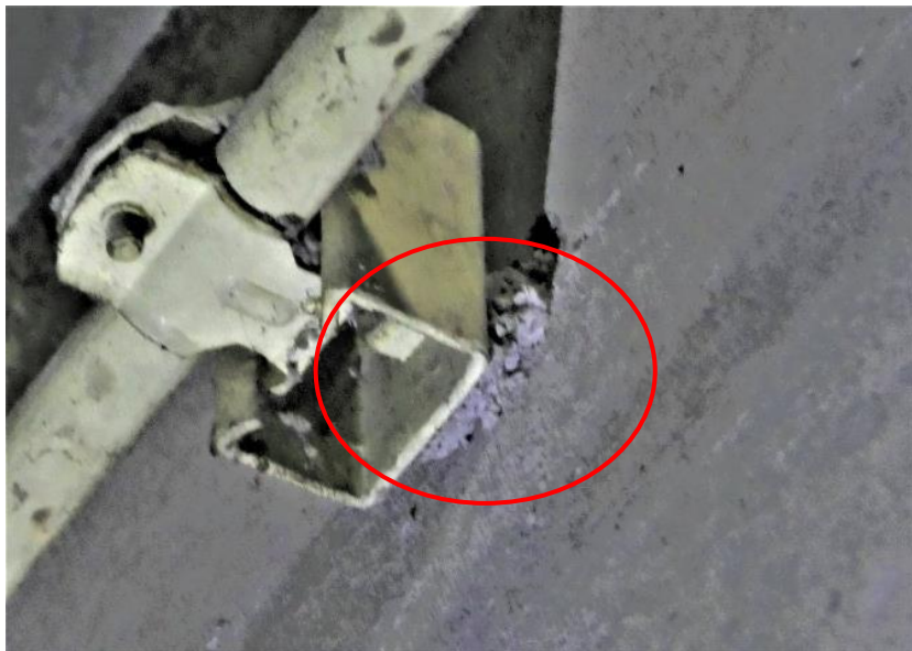
電線管ダクター部の清掃不良
