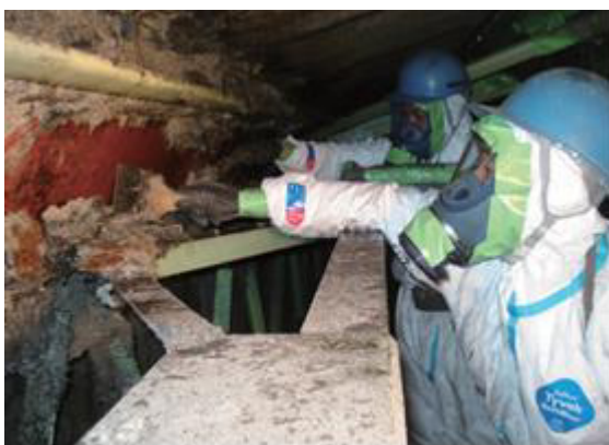
図 4.7.71 手工具（ヘラ）を使用した石綿含有吹付け材の除去作業（ブラッシング）
