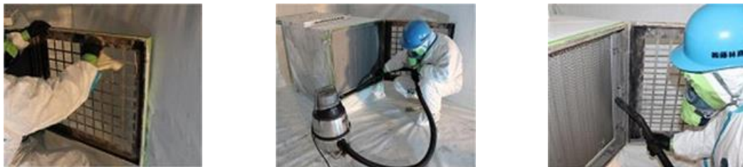
図 4.7.83 HEPAフィルタ等の清掃
