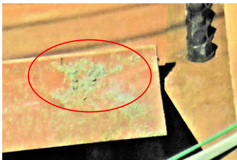
鉄骨梁下の取り残し
