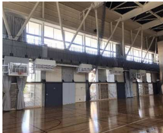
体育館空調設備整備（エアコン）
