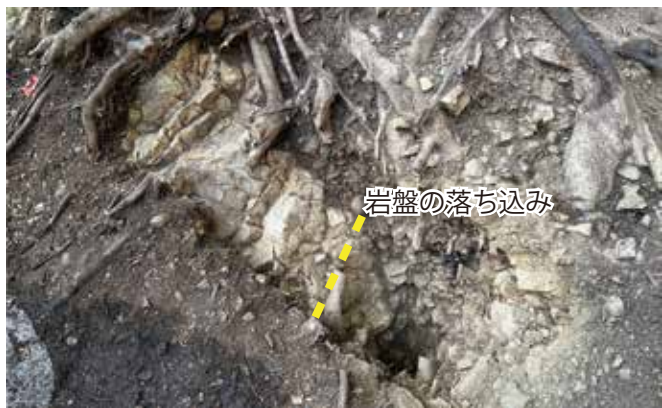
岩盤の落ち込み（近景）
