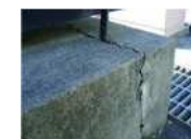
基礎のクラック、支柱と根巻きの隙間、支柱ぐらつき
