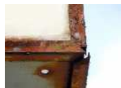
側板・表示面板押さえの腐食、破損、ねじれ、変形、欠損
