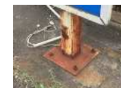
鉄骨のさび発生、塗装の老朽化
