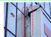
コーキングの劣化・溶接部の劣化等
