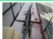
周辺機器(※)の劣化、破損 ※分電盤、配線、変圧器(トランス)、スイッチ等
