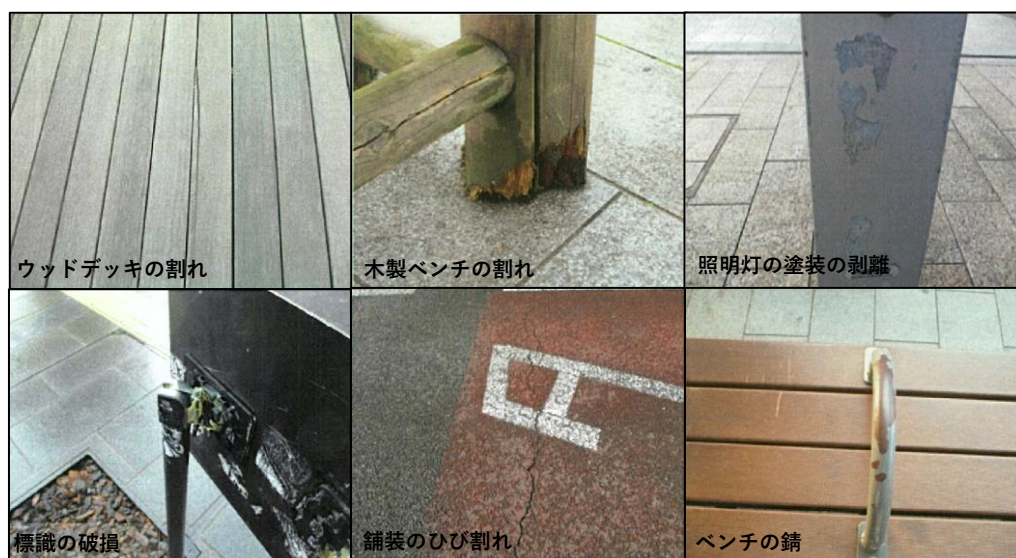
写真3 点検で見つかった劣化箇所の例
