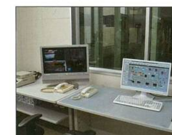
操作室（監視モニター）
