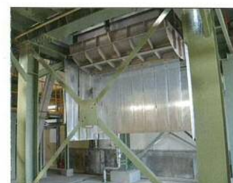
脱水設備（脱水汚泥貯留ホッパ）
