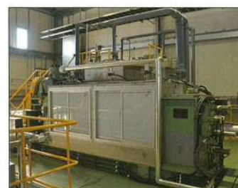
脱水設備（汚泥脱水機）
