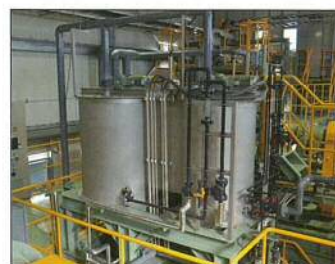
脱水設備（混和槽・凝集槽）
