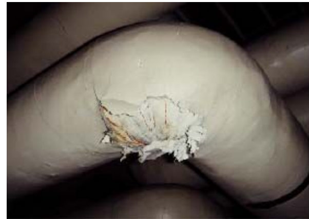
配管エルボの保温材①
