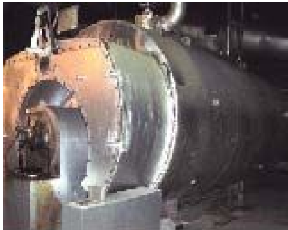
ボイラー の保温材
