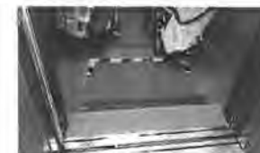
エレベーター
