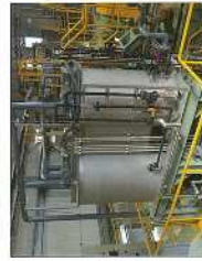
脱水設備(混和槽・薬液槽)
