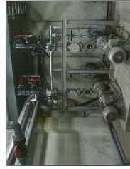
受入貯留設備(破砕ポンプ)
