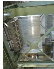
脱水設備(脱水汚泥貯留ホッパ)
