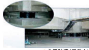
▲免震装置(福島市)
