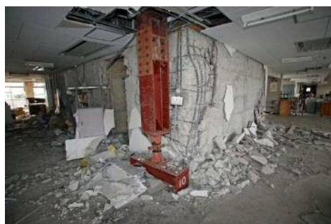
▲東日本大震災で大きな被害を受けた福島県須賀川市庁舎(S44竣工)
