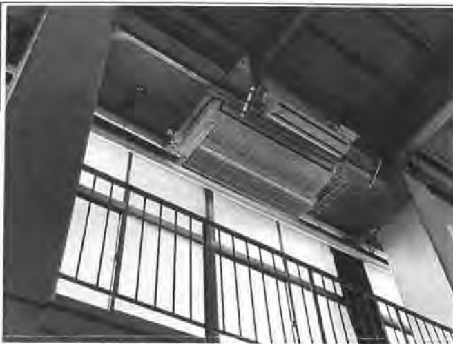
視察した大阪府箕面市体育館のエアコン
