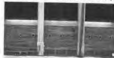
クーラー吹き出し口 岐阜市もえぎの里 多目的体育館(瑞穂町)
