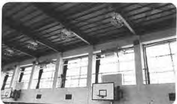
箕面市の学校体育館に設置されたエアコン設備
