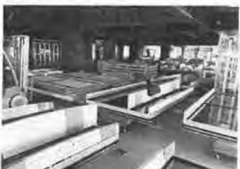
7階へ内装資材が運び込まれ所狭しとばかりに置いてあります。
