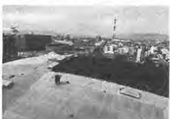
5階から見下ろした議場の屋根。屋根部分は平面でないので工員さんが、一枚一枚パネルを手作業で丁寧に貼ります。
