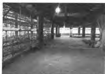
2階フロア、内装はまだまだこれからの状態。完成予定の絵では明るい外壁ですが、完成したらどんな感じになるのか楽しみです。
