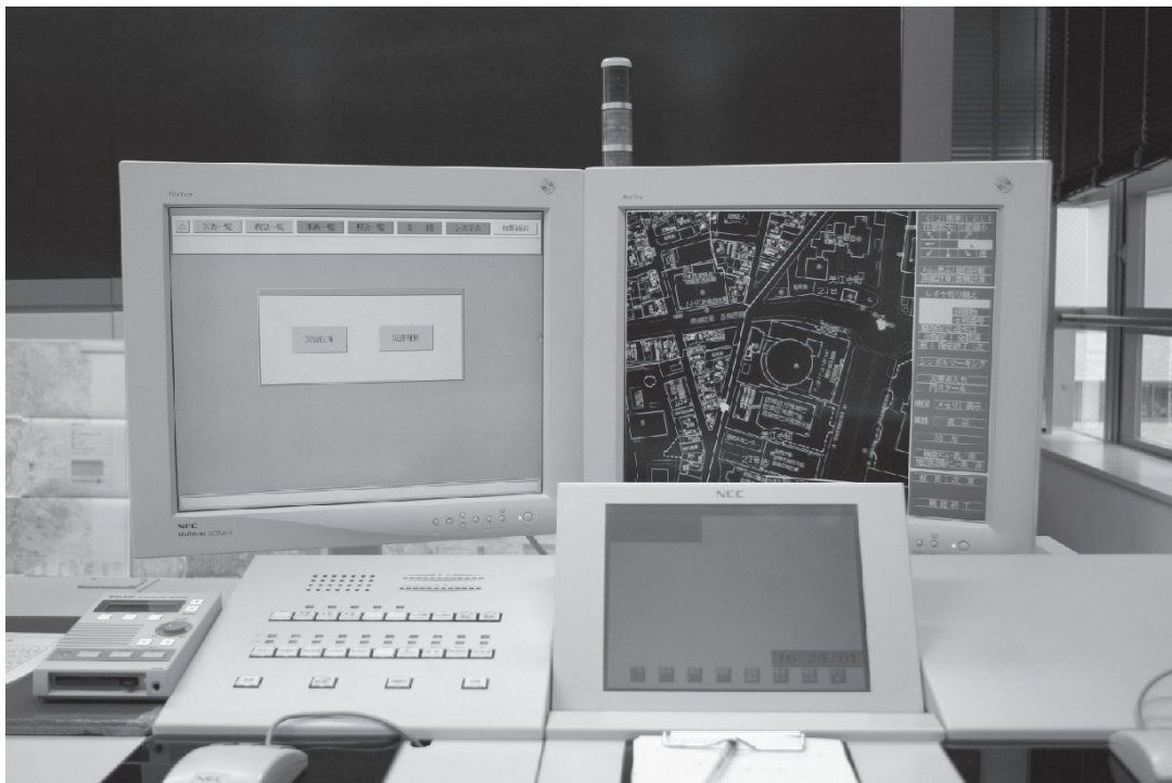
通信指令室 指令台
