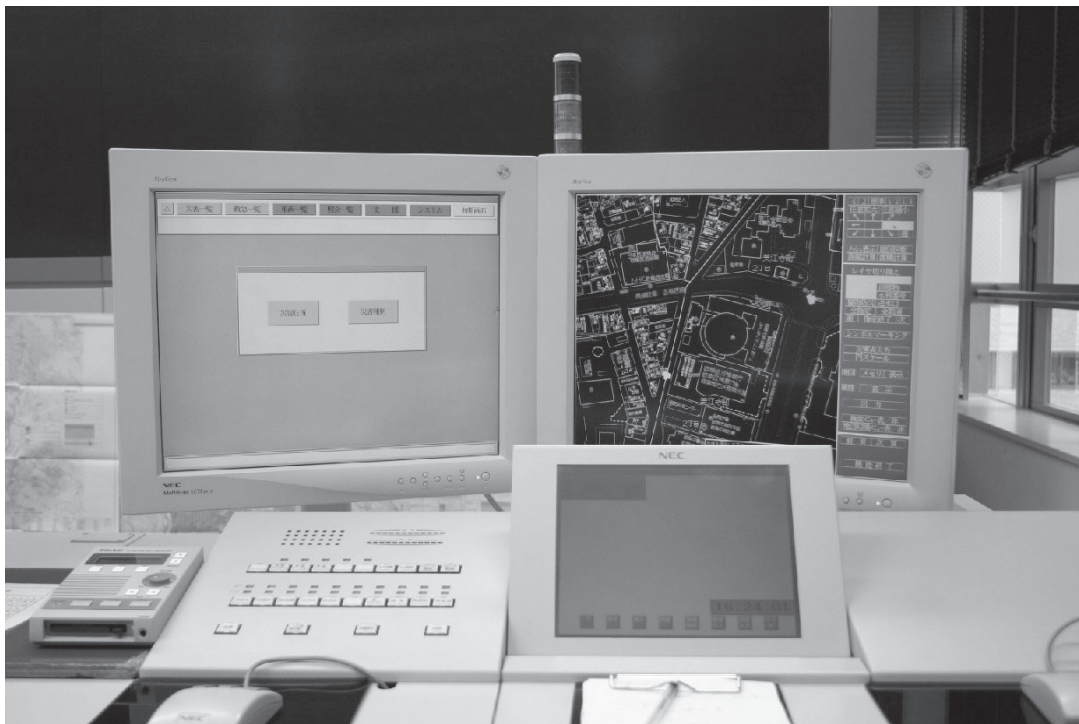
通信指令室 指令台
