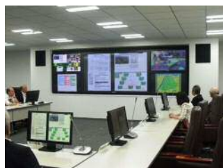
▲災害応急対策の司令塔となる防災会議室(愛知県一宮市庁舎)
